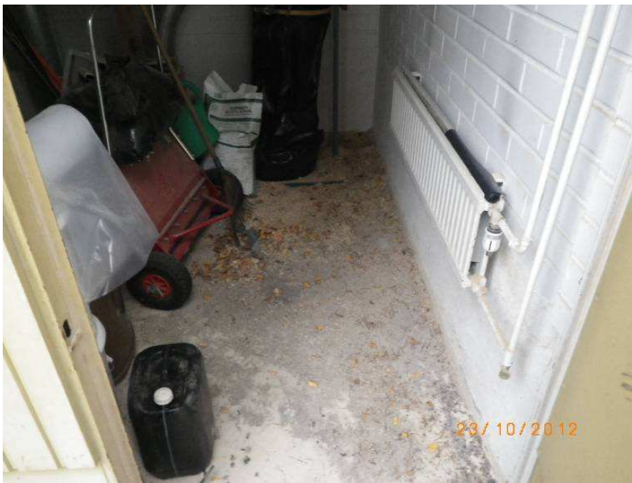
Kuva 2. Purutila, tiiliseinässä rakoilua
