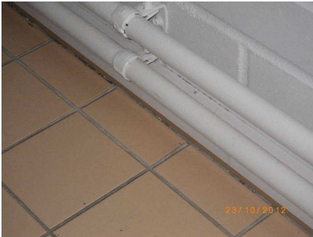
Kuva 10. Lattian ja seinän rajassa rakoilua kirjastossa
