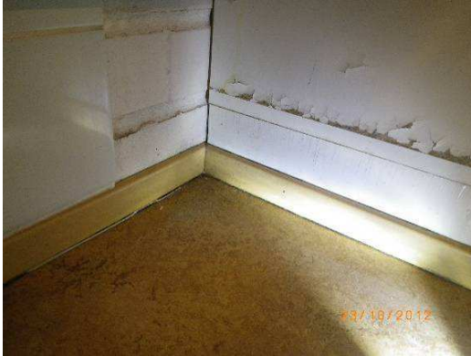
Kuva 11. Kaapin runko turvonnut
