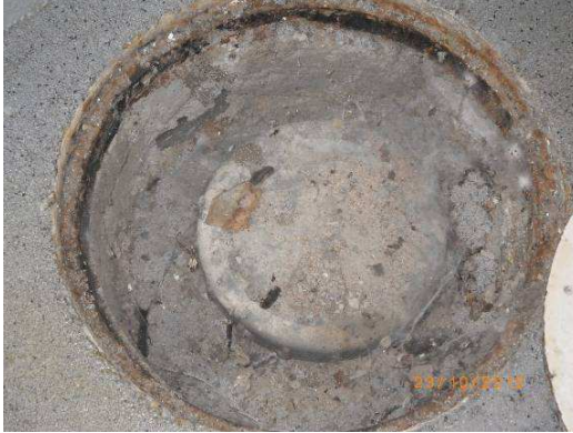
Kuva 18. Siivoajien sosiaalitilojen WC:ssä olevan kaivonkannen alta.
