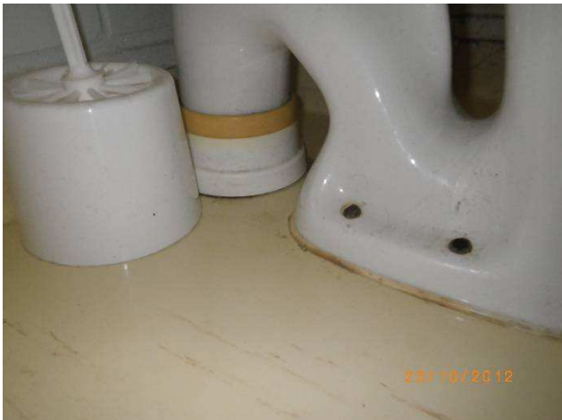
Kuva 9. Likaa WC-istuimen takana.
