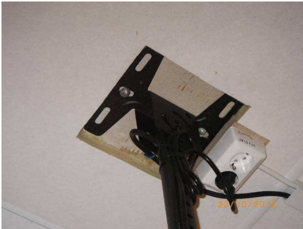
Kuva 12. Äänieristelevyjen reunat paljaana
