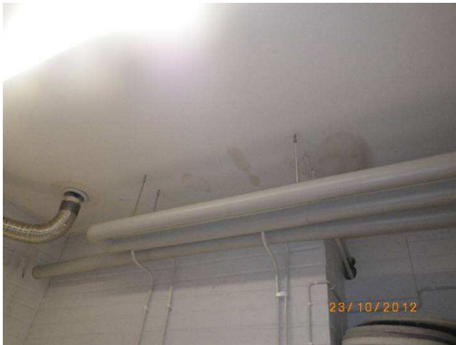
Kuva 7. Siivouskomeron katossa veden aiheuttamia jälkiä
